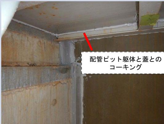
配管ピット内部
